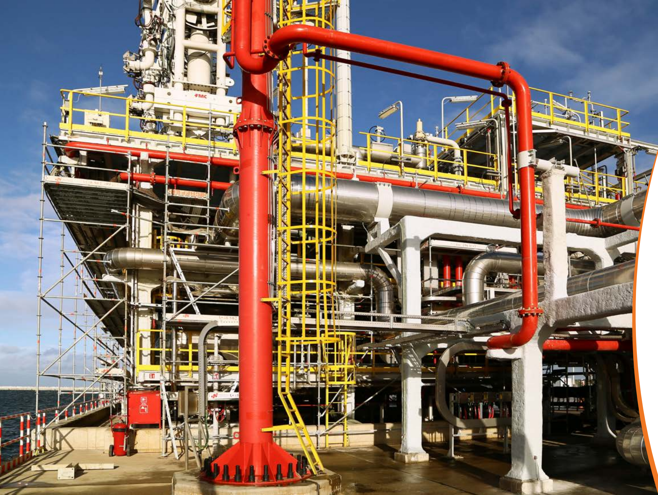
Instalacja przeciwpożarowa Fire protection system 19.11.2015
