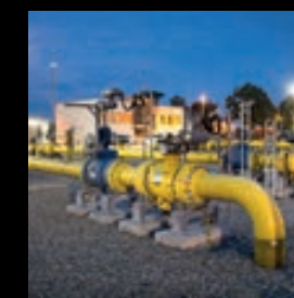
Tłocznia Odolanów Odolanów Compressor Station
