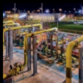
Tłocznia Jarosław Jarosław Compressor Station
