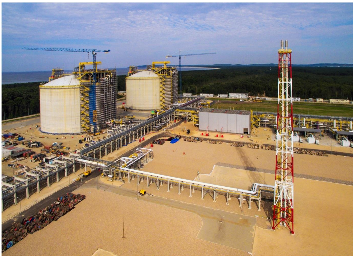
Fot. 19. Zbiornik na LNG oraz widok na estakady i wieżę wydmuchów.
